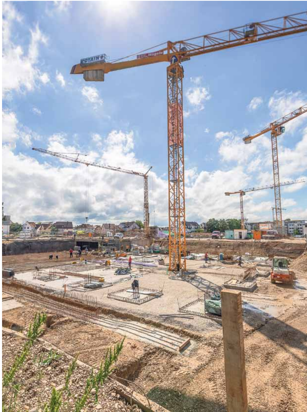
Den Bau der Tiefgaragen kann man im Kirchheimer „Steingau-Quartier“ beobachten. Foto: Carsten Riedel
