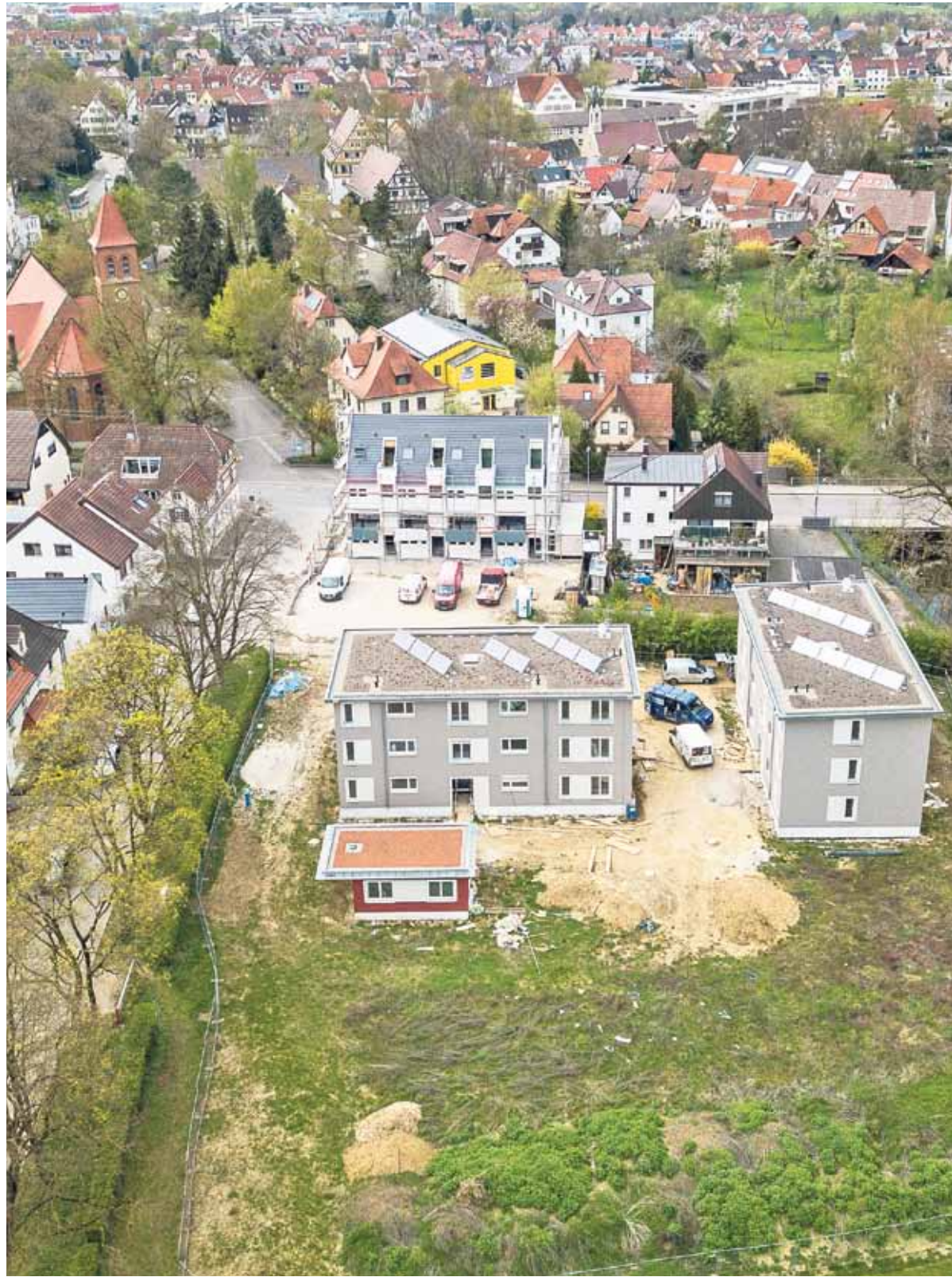
Die Neubauten auf der Kirchheimer Klosterwiese sind so gut wie fertiggestellt. Schon im Mai sollen Flüchtlinge dort ihre Wohnungen in der Anschlussunterbringung beziehen. Foto: Carsten Riedel
