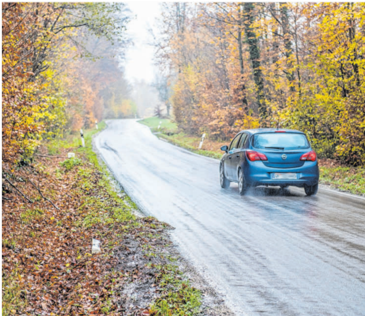
„Normalerweise kann man die Straße nicht mehr befahren“, sagt der Schlierbacher Bürgermeister Paul Schmid über den Zustand der Strecke zwischen Schlierbach und Ohmden. Foto: Giacinto Carlucci
